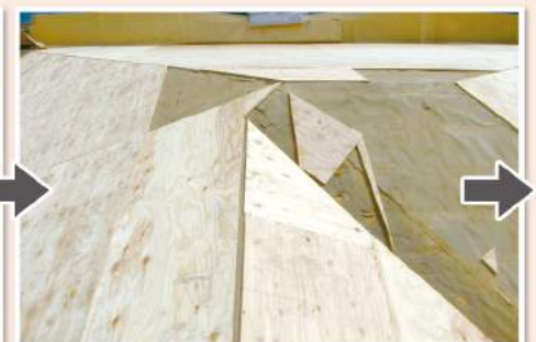
瓦・瓦棧を撤去後、新しい下地ベニヤを 全面に張ります。
