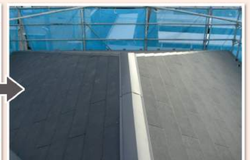
工事完了! 工事の作業過程は写真にて お客様へご報告いたします。
