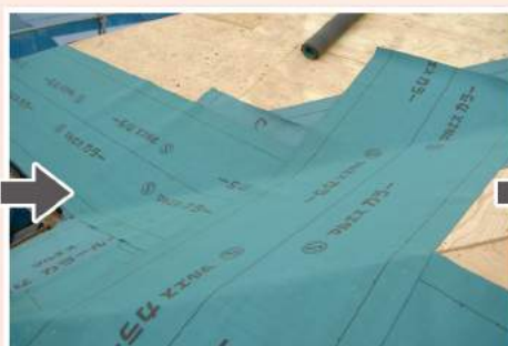
きちんと下地づくりが終わってから 新しい防水紙を張っていきます。
