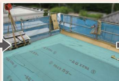
全面に防水紙を張り終わり、 新しい屋根材を荷上げしている様子。
